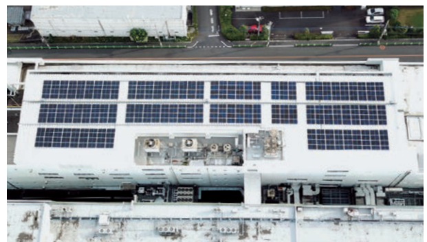
本社3号館屋上の太陽光発電設備
