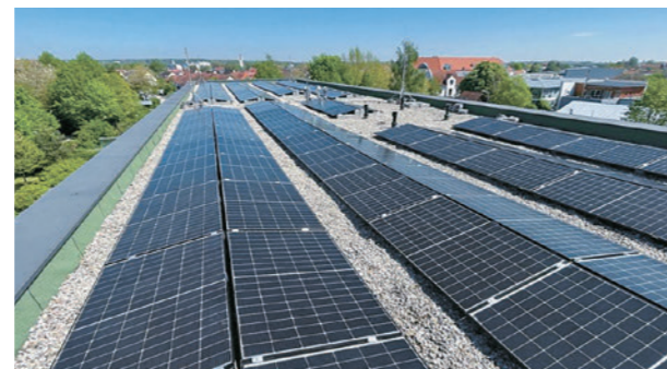
屋上に設置した太陽光発電パネル
