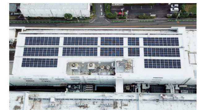
本社3号館屋上の太陽光発電設備
