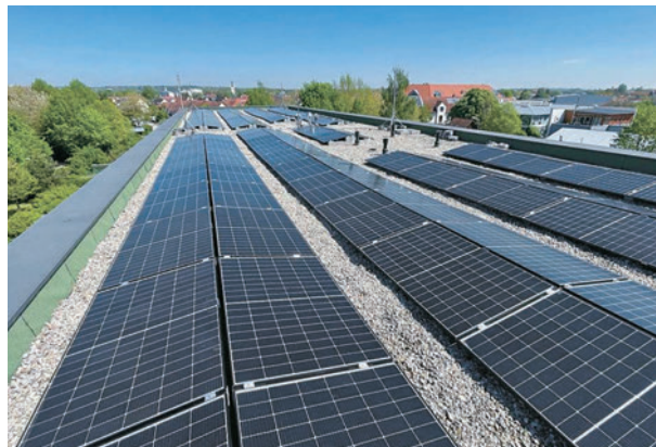
屋上に設置した太陽光発電パネル
