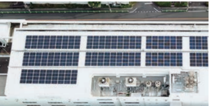
本社3号館屋上の太陽光発電設備
