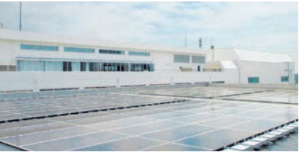
2024年7月より稼働した本社6号館屋上の太陽光発電設備
