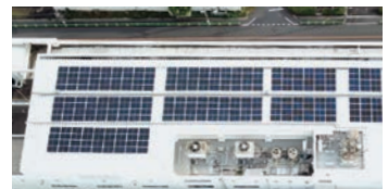
本社3号館屋上の太陽光発電設備
