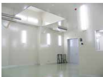
クリーンルーム
