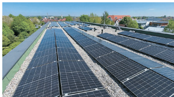
屋上に設置した太陽光発電パネル
