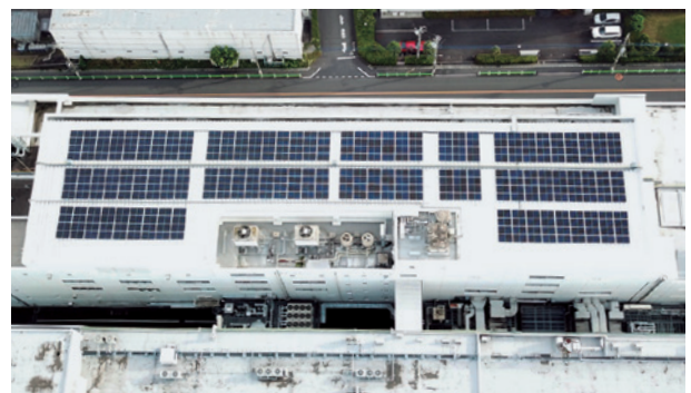
本社3号館屋上の太陽光発電設備
